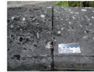
Die Fugen sind defekt, teilweise ist der Mörtel bereits ausgewittert. Die kleinen Aushöhlungen sind materialimmanent.
