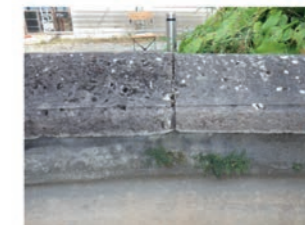
Horizontale Risse mit Pflanzenbewuchs im oberen, dunkel verfärbten Randbereich des Brunnenbeckens.
