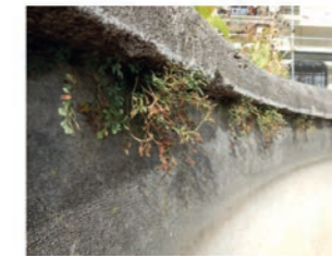
Die Lagerfuge ist beinahe vollständig ausgewittert, unter den Randsteinen hat sich bereits Humus gebildet. Eine ausgeprägte Besiedlung durch höhere Pflanzen ist erkennbar.
