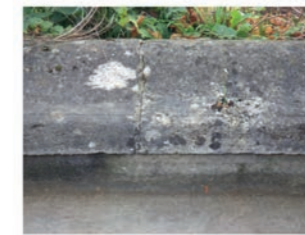
Die Randsteine sind substanzmäßig in gutem Zustand. Sie weisen einen Biofilm aus Algen, Moosen und Flechten auf, die Oberfläche ist stellenweise leicht verkrustet.
